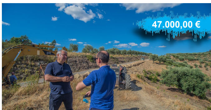
Abastecimento de Água em caixa baixa a Nozelos.
