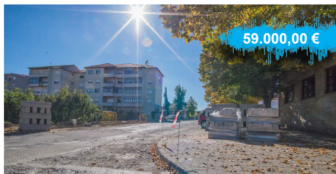
Pavimentação na Rua dos Bombeiros Voluntários entre a Av. Infante D. Henrique e a R. Álvaro de Castro.
